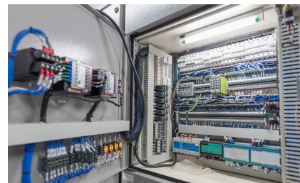
制御盤・操作盤
