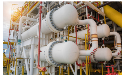
タンク・塔槽類
